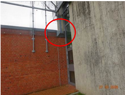
(32) Notablauf, untere Dachfläche
