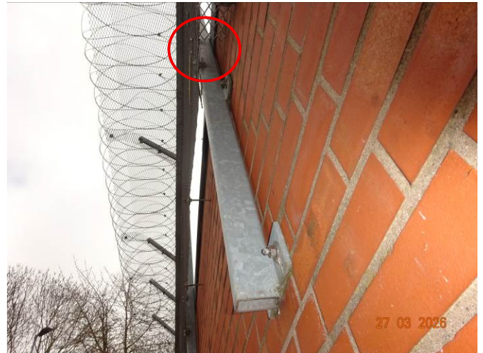
(21) Detailansicht – Pfosten direkt an Mauerwerk angebracht
